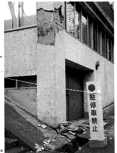
主柱のコンクリートの剥離(県林業会館で)
