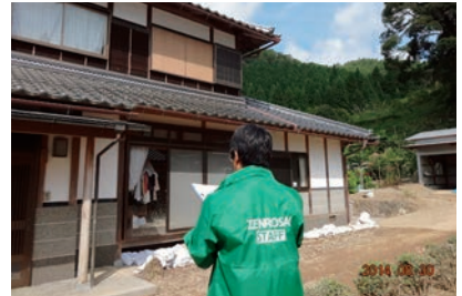
丹波大雨災害の被災組合員宅の損害調査。(兵庫労働経済生協・2014年8月)
